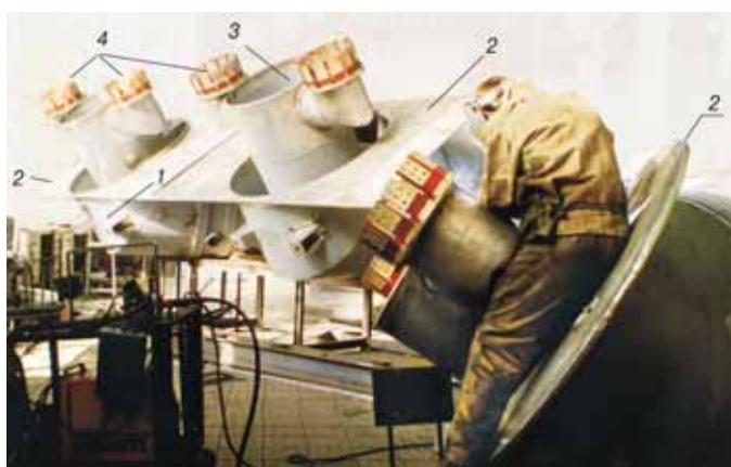
Рис.11. Блок подсоединения токопровода к силовому трансформатору. 1 – кожух-экран; 2 – плата перемычка экранов; 3 – шина токоведущая; 4 – контактные переходы.
