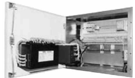
Отсек низковольтной аппаратуры
